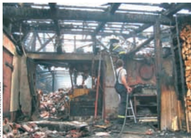
S podtikanjem ognja je Nejc Markelj največ škode povzročil podjetju Trgos, saj so 27. junija 2012 v celoti pogoreli poslovni prostori podjetja v Lescah.
